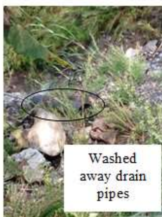
(d) Washed Away Drain Pipe
